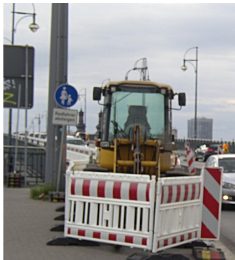
Baustelle auf rheinaufwärts gelegenen Seite der Brücke im Sommer 2014 (Foto: VCD Rheinhessen)
